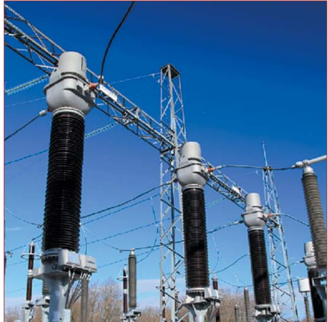
Рис. 3. Каскадний трансформатор напруги 330 кВ
