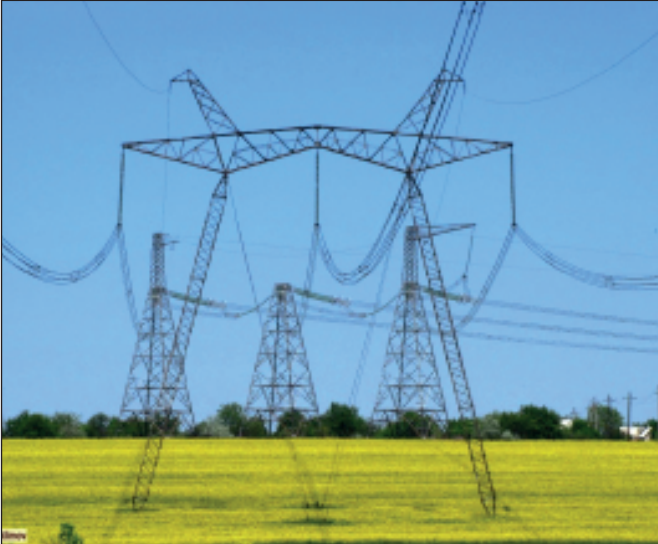
Рис. 1. Лінії електропередачі надвисокої напруги
